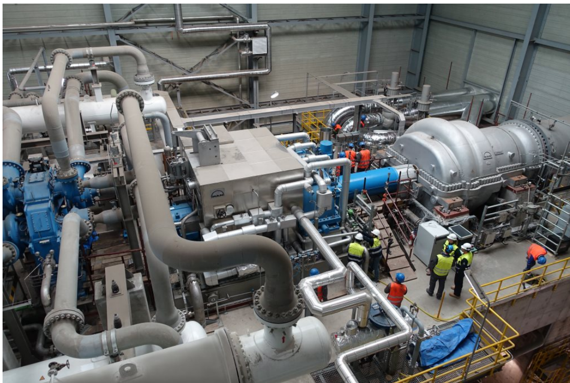
(MDT_AR_MAX1_1.jpg) Einer der vier AIRMAX S-Stränge auf der Air Products Baustelle in Yulin
